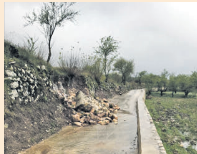
Danys ocasionats per les fortes pluges
