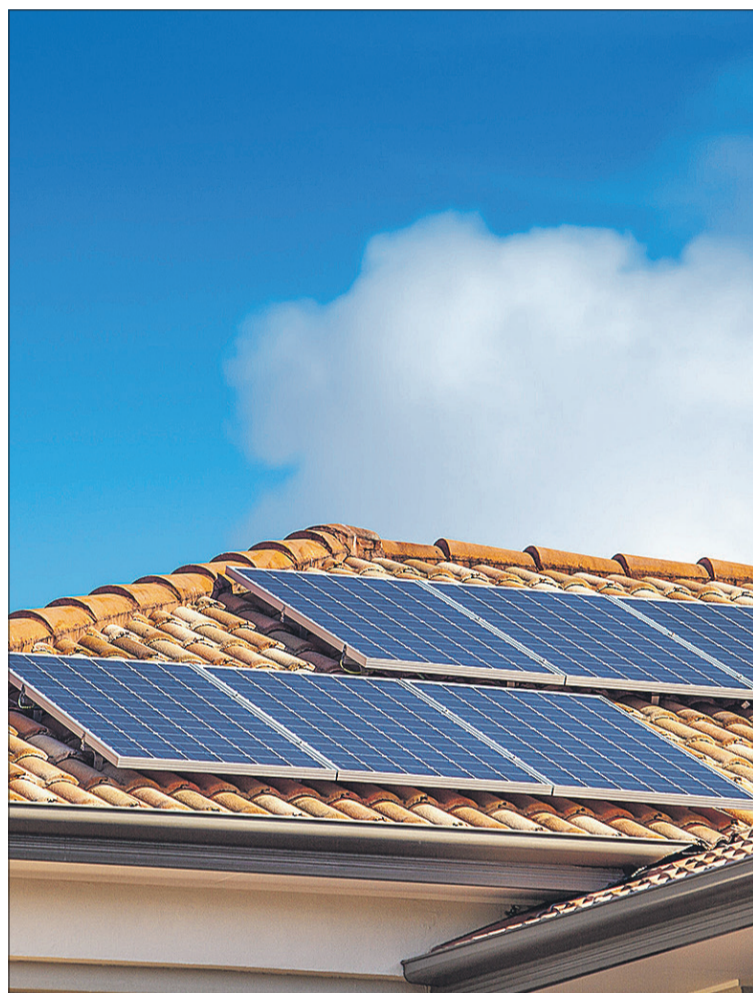
Placas solares en el tejado de una vivienda.
